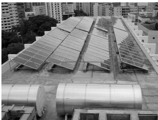
Aquecedor Solar Soletrol em edifício de apartamentos
