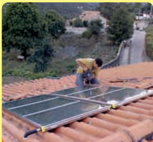
Instalação em Portugal
