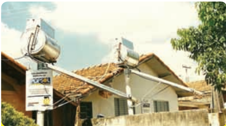
POPSOL instalado em residência da COHAB em São Manuel-SP
