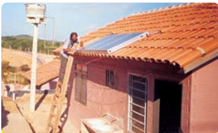
Instalação no pioneiro projeto de Sapulcaias
